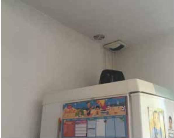
Photo 2 : le conduit de ventilation naturelle (bouche de gauche) contrarie l'efficacité du tirage de la bouche d'extraction de la VMC (à droite), empêchant un balayage efficace de l'air des pièces sèches vers les pièces humides.
