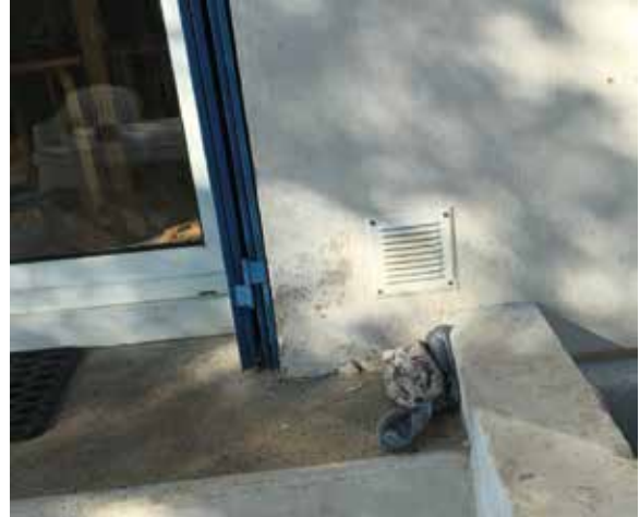
Photo 3 : Lors de l'installation de la VMC, dans les années 90, les ventilations basses en façade des cuisines et WC avaient été condamnées par des plaques PVC, afin de ne pas court-circuiter la circulation de l'air des pièces principales vers les pièces humides. Lorsque ces plaques sont absentes ou non étanches, le balayage ne peut se faire correctement.
